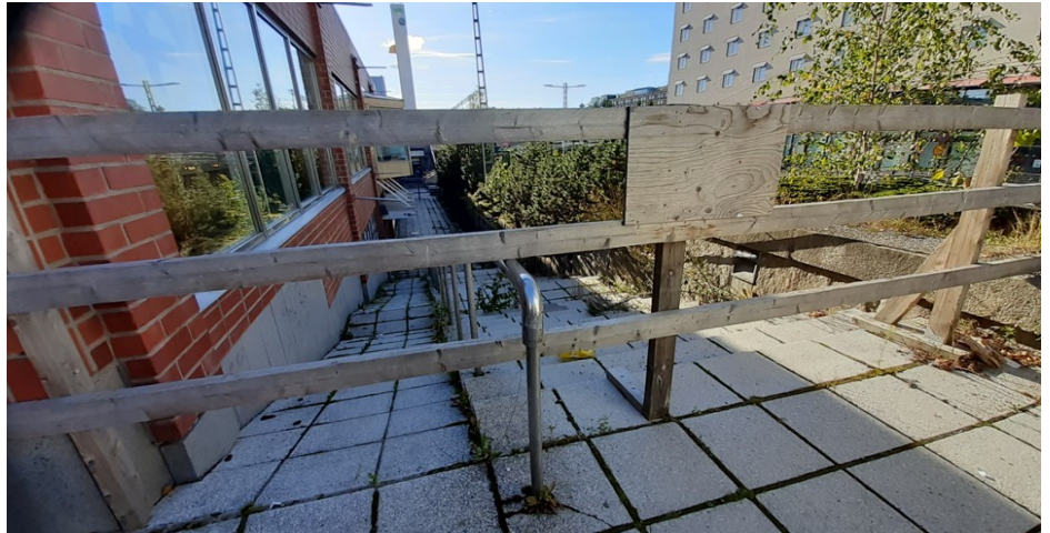
Näkymä rakennuksen pohjoispuolisen portaikon yläpäästä kohti Itsenäisyydenkadun tunnelia elokuussa 2022. Huonokuntoinen portaikko oli poistunut yleisestä käytöstä jo muutamaa vuotta aiemmin. Vuonna 2023 portaikkoa oli kunnostettu ja kaavaehdotusta laadittaessa se oli jälleen yleisessä käytössä. (Kuva: Tampereen kaupunki)
